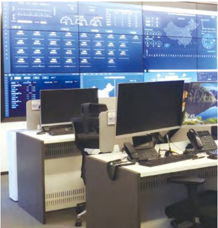
ECC 控制中心
